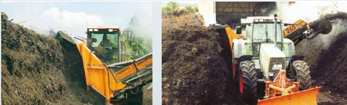
Umsetzen und Sauerstoffeintrag bei Kompostmieten, kontaminierten Böden und mechanisch-biologischen Anlagen
